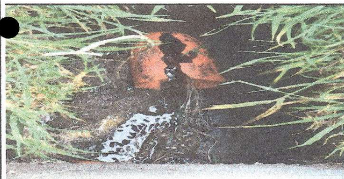
Foto 5: Red de drenaje en mal estado.
