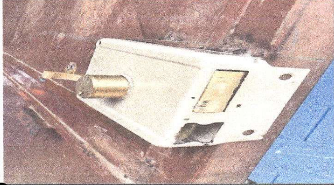
Foto 1: Chapa en mal estado.
