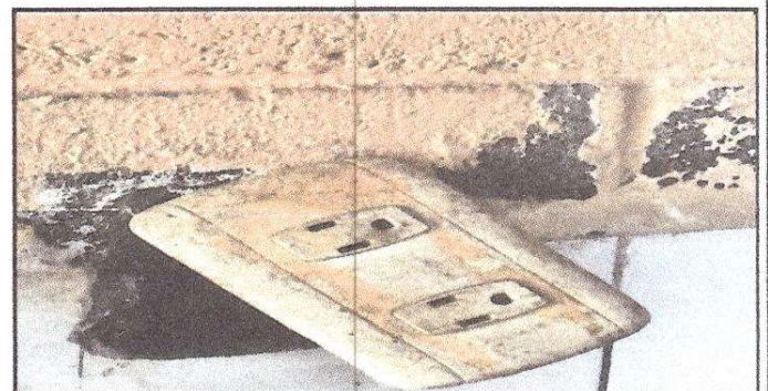
Foto 6: Placas de tomacorrientes destruidas.
